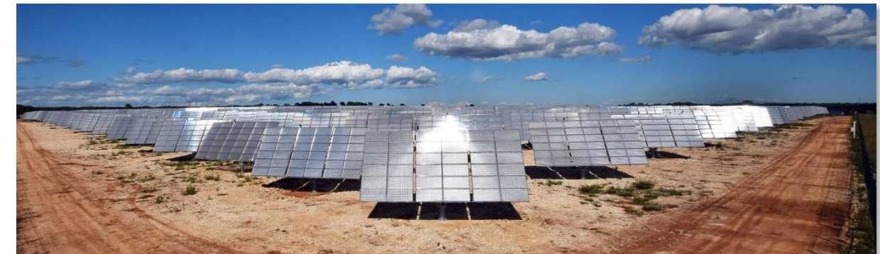
Figure 11 : Centrale solaire (source : URBASOLAR, 2017)
