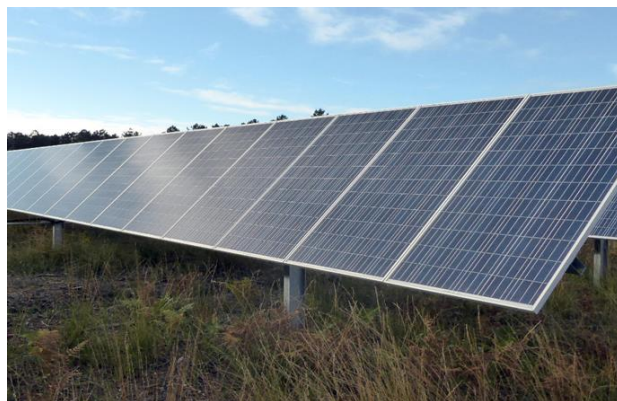
Figure 17 : Illustration de structures fixes sur pieux (source : URBASOLAR, 2018)
